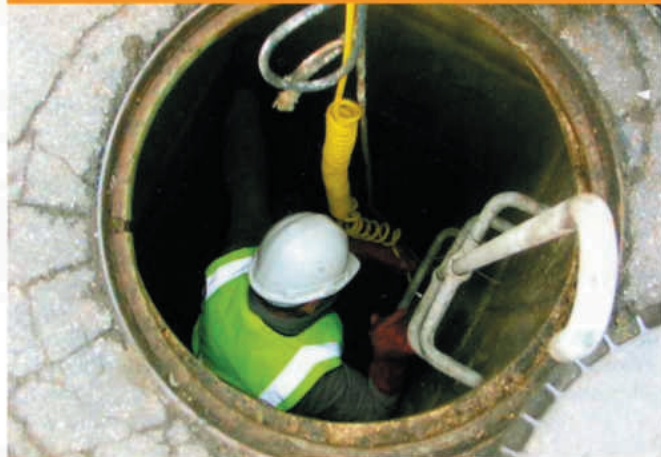
Une inspection du réseau est nécessaire afin de réhabiliter correctement les canalisations
